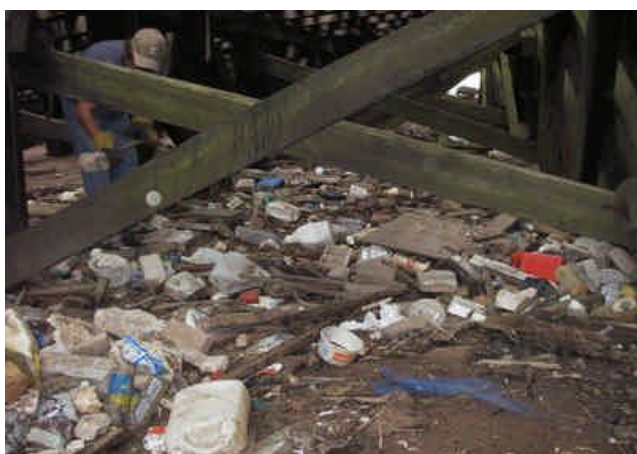
Nettoyage du dessous de la rampe de débarquement à l'Île d'Entrée (avant).
